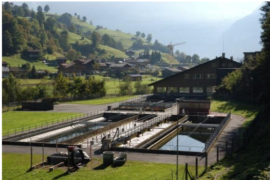
Der Bau von Abwasserreinigungsanlagen im ländlichen Raum als wichtiger Teil der kommunalen Infrastruktur (hier am Beispiel von Grindelwald) gehörte zu den durch das IHG mitfinanzierten Projekten.
